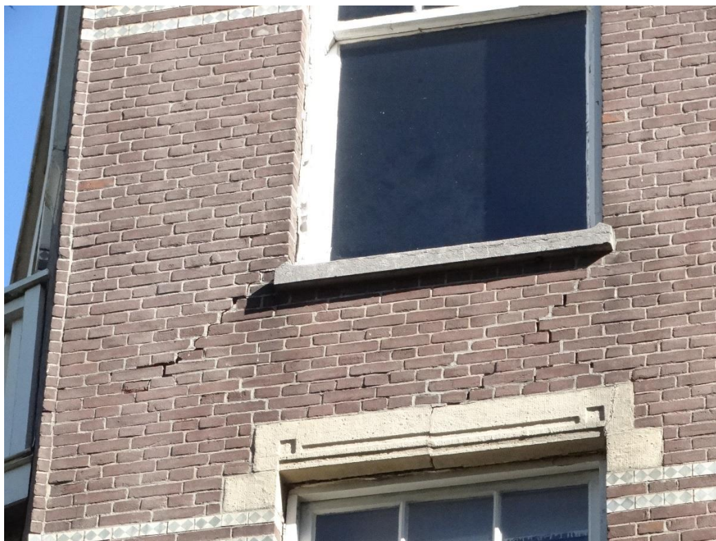
Scheur als gevolg van roestend staal van stalen balken in de kopgevel en breuk rollaag boven raam als gevolg ontbreken staal.
